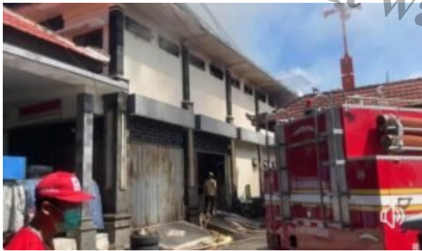
Kondisi gudang logistik BPBD Bali yang terbakar
